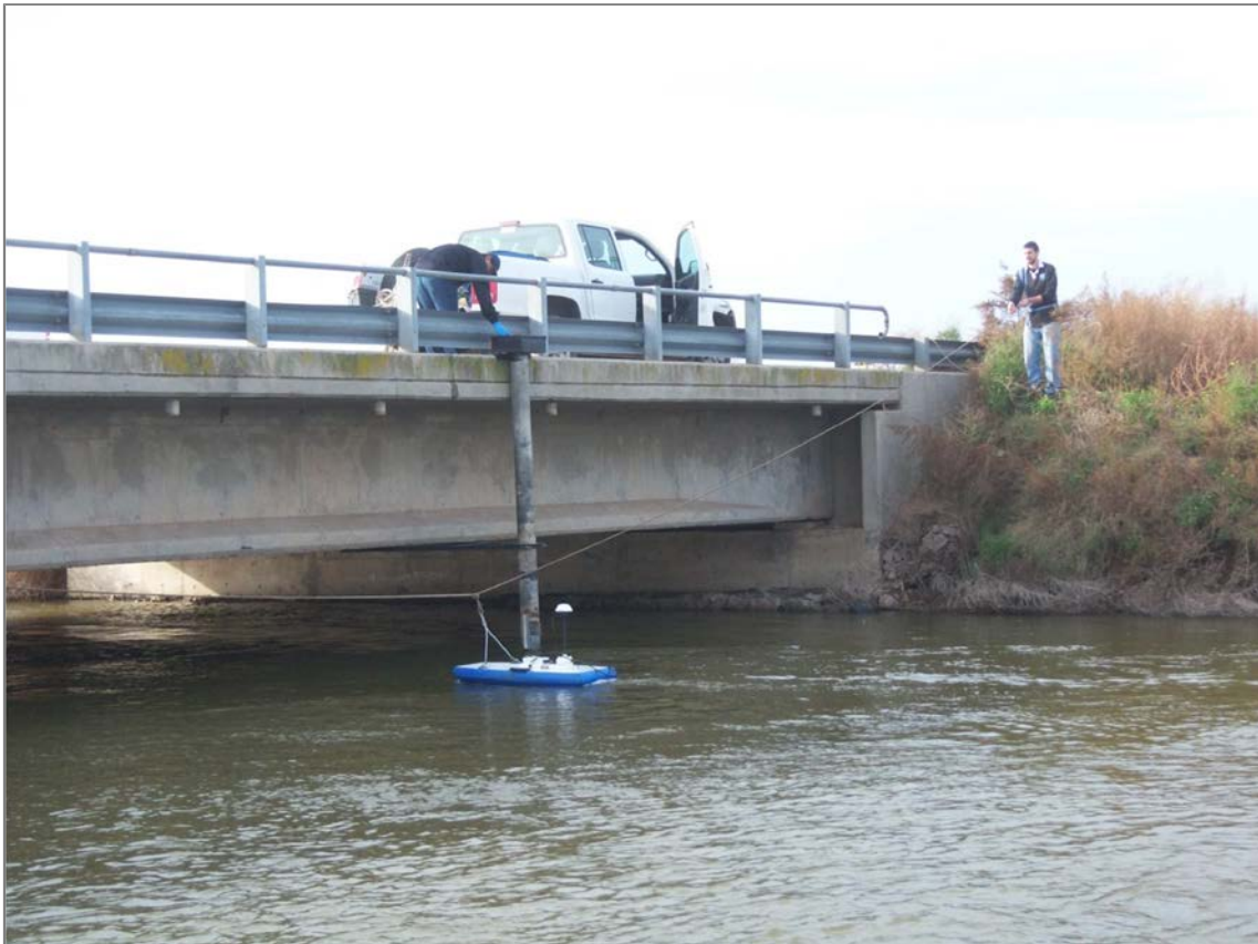
Figura 2: Estructuras instaladas sobre Puente carretero en Onagoity
