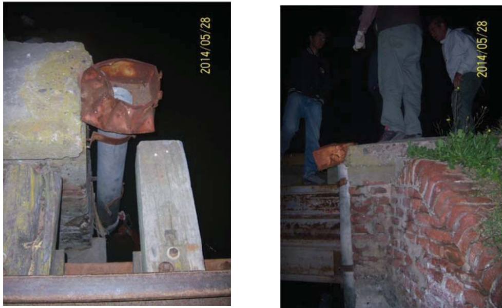
Figura 14: Instalación sobre la sección del Río V en Onagoity
